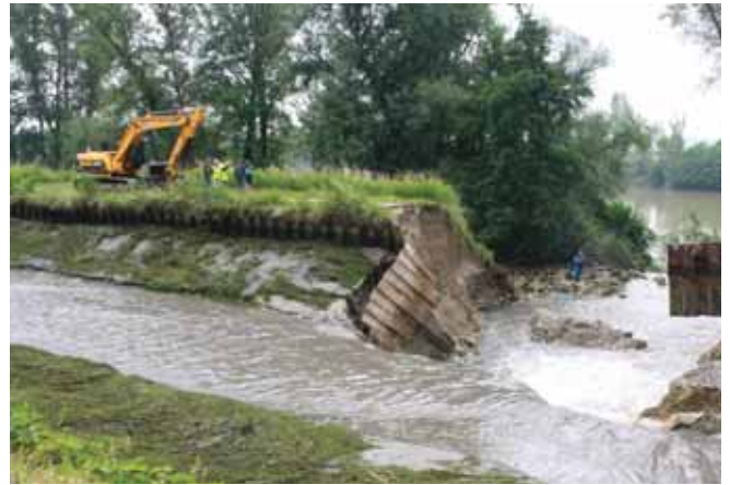
▲ Meilhan-sur-Garonne, une brèche est apparue le 11 juin (© Sud Ouest / Camille de Lapoyade)
